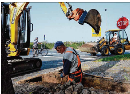
Rückblick: In Staßfurt hatte die primacom mit dem Breitbandausbau 2017 für die Häuser der Wohnungsbaugenossenschaft begonnen. Jetzt geht es im Rest der Stadt weiter. Archivfoto: F. Richter
